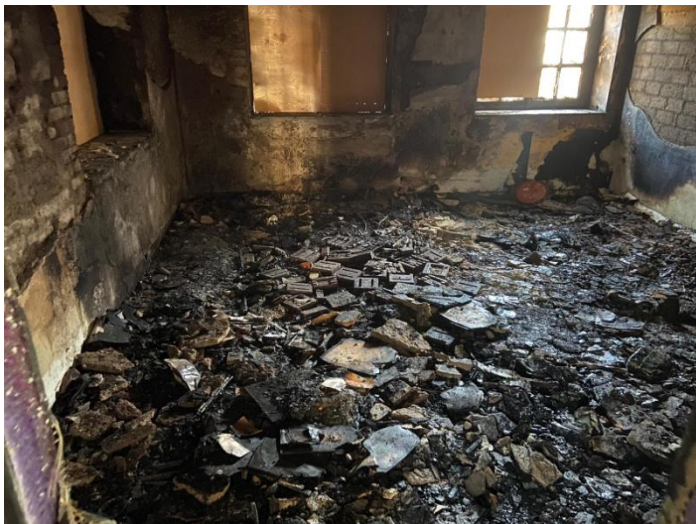
Das Büro im HdG nach Ende der Löscharbeiten, gut erkennbar, welche Hitzeentwicklung hier vorgelegen hat.
